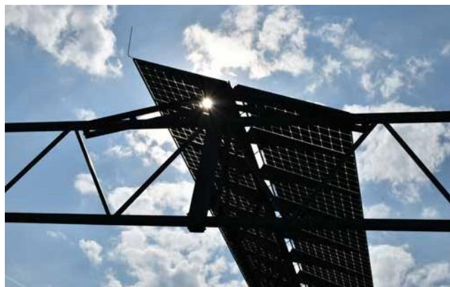
図14：ヘッゲルバッハのアグリボルタシステムにおける二面性モジュールを用いたモジュール列。©Fraunhofer ISE
