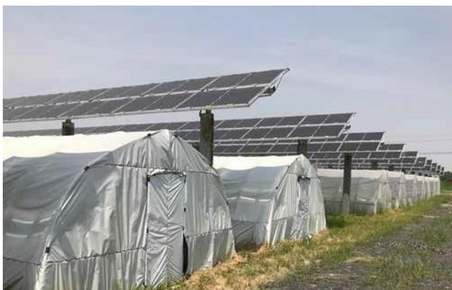
図 36: フォイルトンネル上のPVモジュール。
