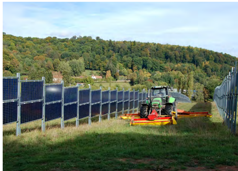
Abb. 45: Vertikal errichtete, bifaziale Module im Solarpark in Eppelborn-Dirmingen, Saarland, mit 2 MW p Leistung, errichtet von Next2Sun © Next2Sun GmbH
