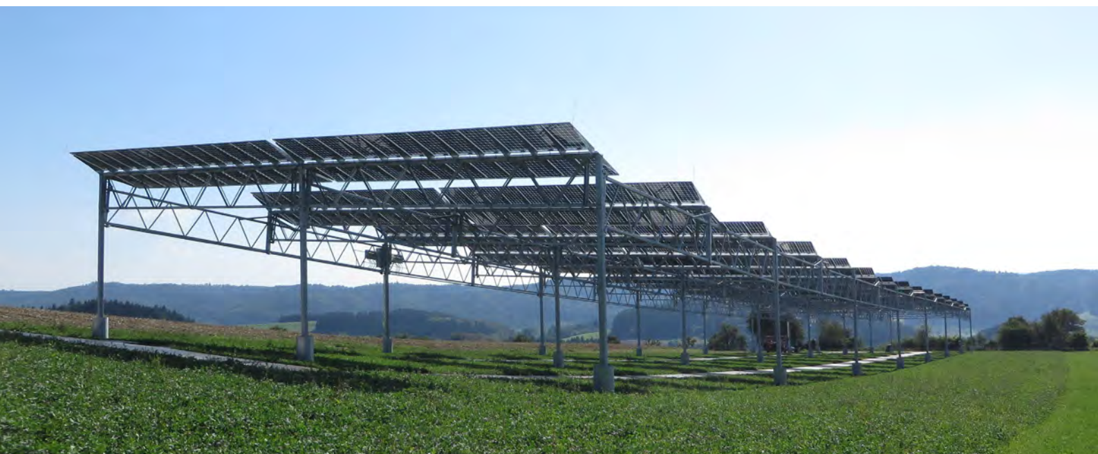
Abb. 1: Agri-PV-Forschungsanlage am Bodensee © Fraunhofer ISE
