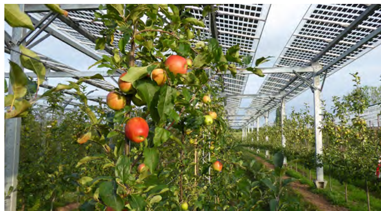
Abb. 16: Agri-PV-Anlage auf dem Bio-Obst-hof Nachtwey (2021, 2023) © Fraunhofer ISE
