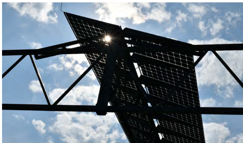
Abb. 24: Modulreihe mit bifazialen Modulen der Agri-PV-Anlage in Heggelbach © Fraunhofer ISE
